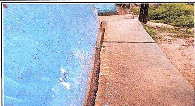
Foto 1. Vista lateral de grieta de la banqueta a intervenir
